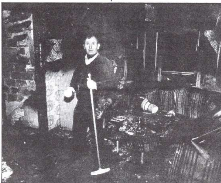
El vecino afectado por el incendio La vivienda quedó inservible (Foto: Juan Guerrero).
